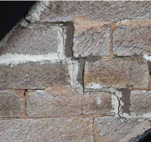
Mehrfach nachverfugter Setzungsriß und lockeres Fugenmaterial
