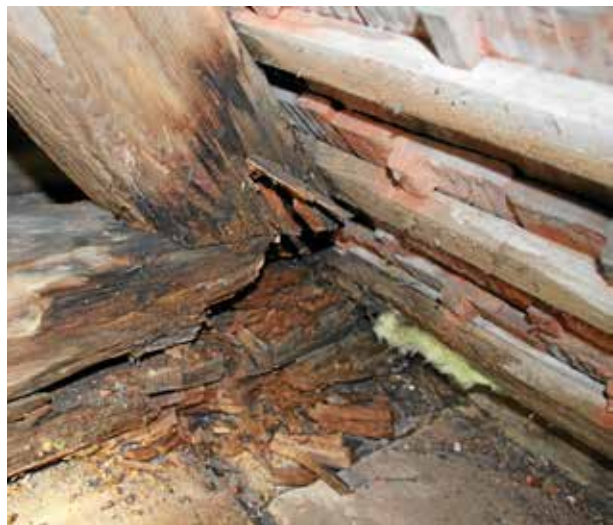
Fäulnisschäden im Dachstuhl
